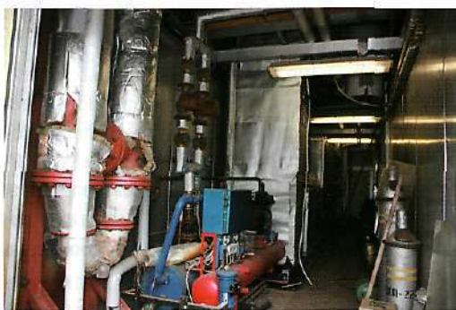
Рис. 2. Оборудование для приточно-вытяжной вентиляции модулей
